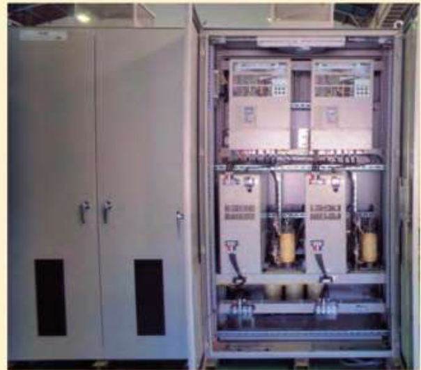
インバータ換気動力盤
